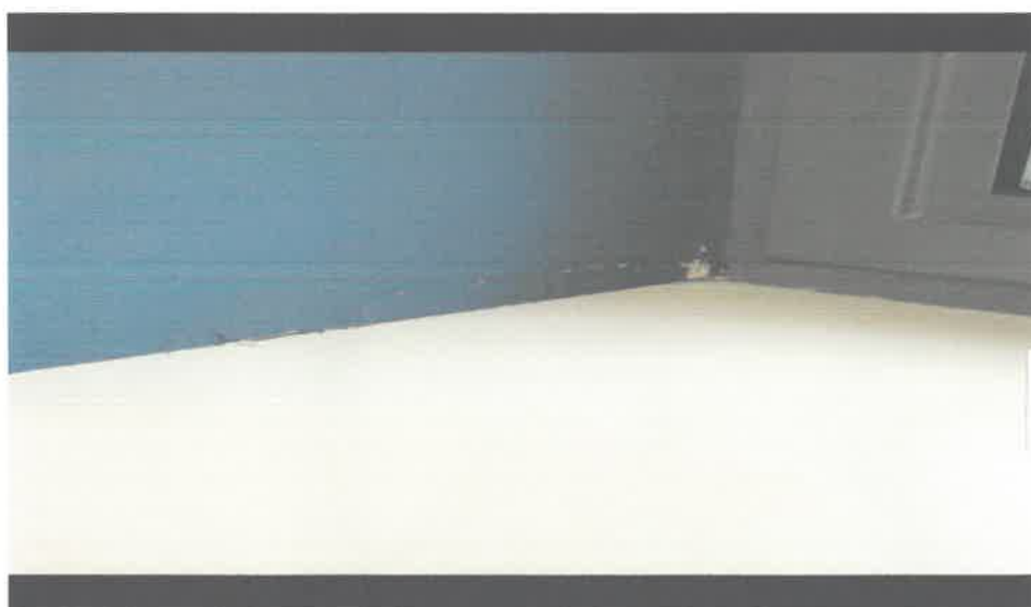
Zdjęcie nr 12- pęknięcie przy oknie w pomieszczeniu na piętrze
