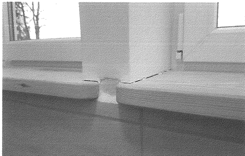
Zdjęcie nr 2- parapety w świetlicy- pęknięcia na łączeniach
